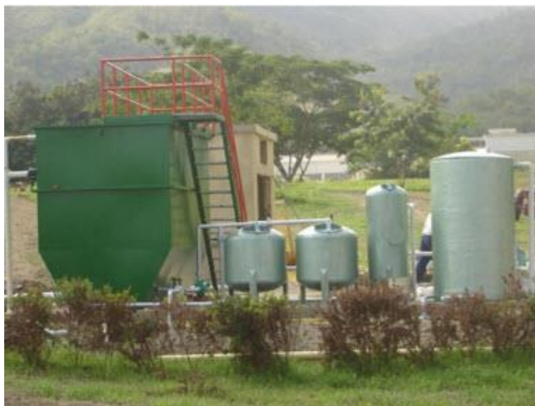
Figura 6.22.10. Tratamiento de aguas potable y desmineralizada
